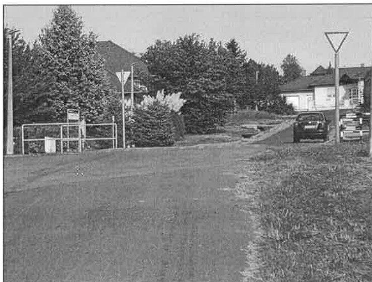
8. sz. fénykép: A Kamilla utca és a Viola utca csatlakozásában lévő, nem megfelelően észlelhető burkolatmagasítás
