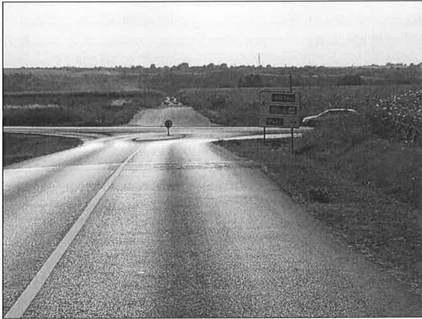
7. sz. fénykép: A József A. utca 578. sz. főúti csatlakozásában nem megfelelően észlelhető „Elsőbbségadás kötelező” jelzőtábla és forgalomterelő sziget
