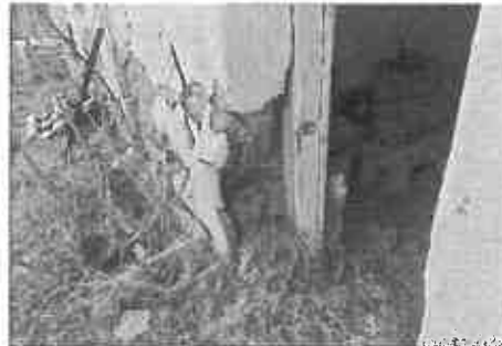
20. Felázott falazat - gazdasági épület
